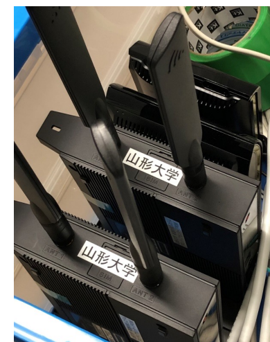
遠隔計測用ネットワーク機器
